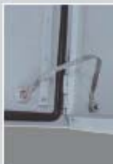
接地线 Grounding wire
